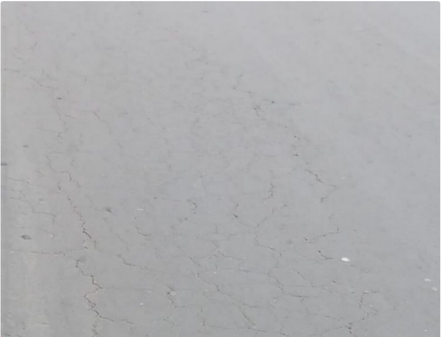
Proyek Jalan PU Kota Palu Mulai Retak Kulit Buaya
